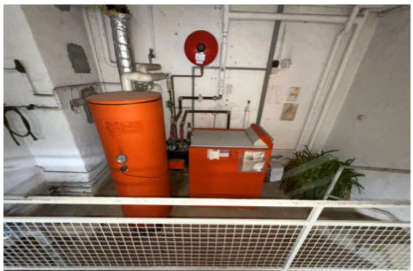
Abb. 14: Foto des SV; Heizungsanlage nicht zeitgemäß
