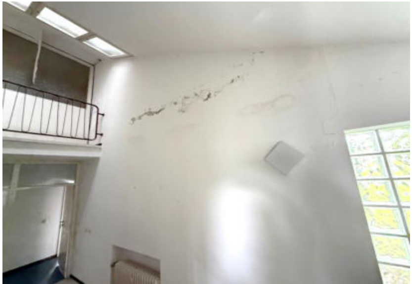
Abb. 6: Foto des SV; z.T. Putzschäden im Treppenhaus
