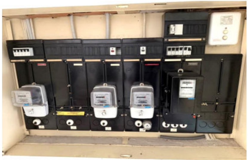
Abb. 13: Foto des SV; Elektroinstallationen nicht zeitgemäß
