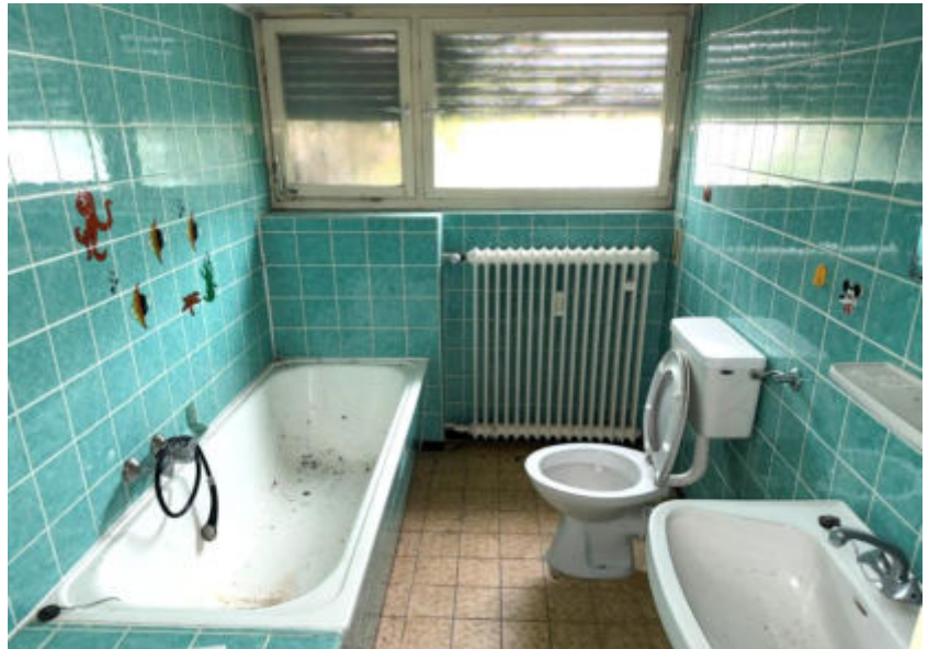
Abb. 12: Foto des SV; Sanitäre Objekte überaltert (Bad UG)
