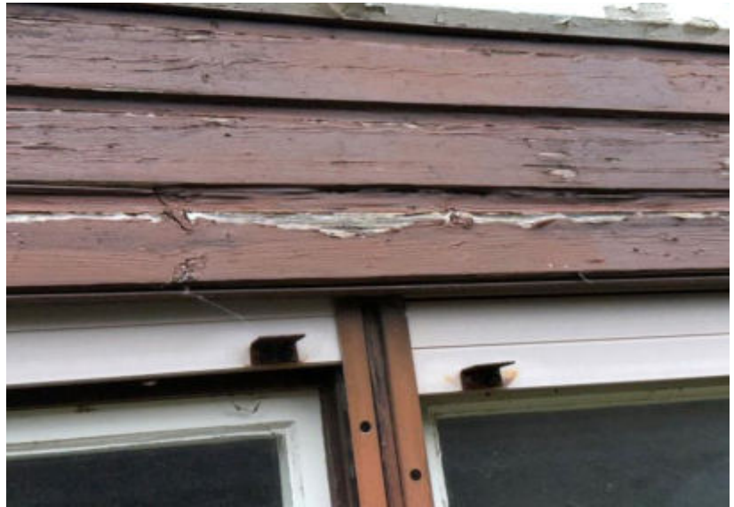
Abb. 3: Foto des SV; z.T. Holzverkleidung überaltert/schadhaft
