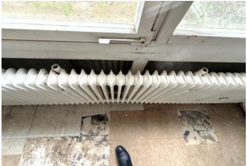
Abb. 7: Foto des SV; z.T. Bodenbelag schadhaft (EG)
