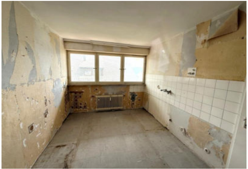
Abb. 9: Foto des SV; Raumbooberflächen überaltert/schadhaft (EG)
