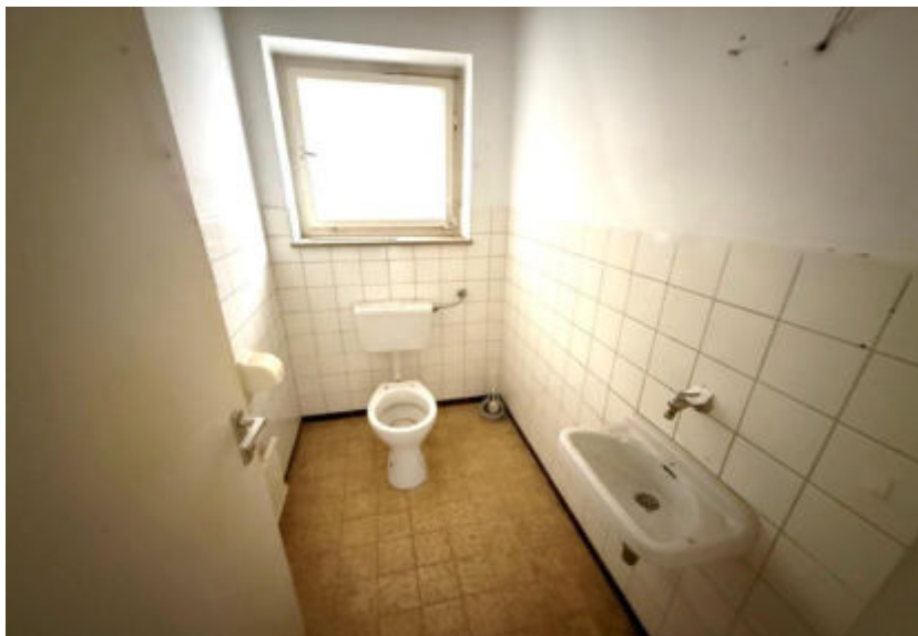
Abb. 11: Foto des SV; Sanitäröbjekte überaltert (WC EG)
