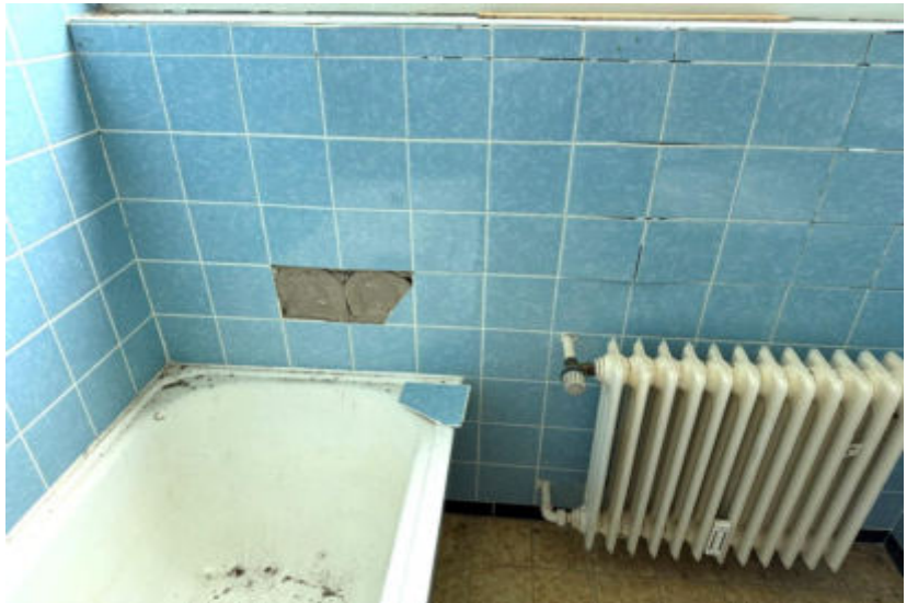
Abb. 10: Foto des SV; Raumbooberflächen überaltert/schadhaft (Bad EG)
