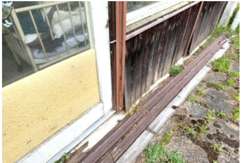
Abb. 4: Foto des SV; z.T. Holzverkleidung überaltert/schadhaft
