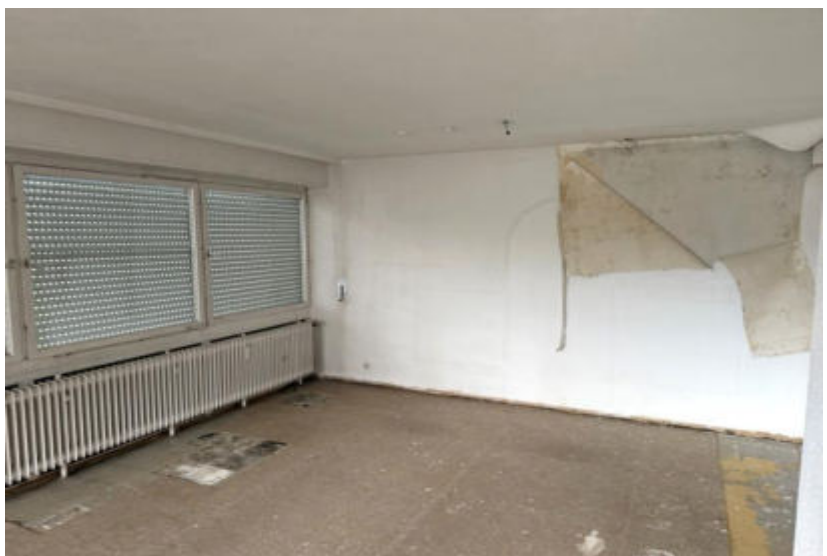
Abb. 8: Foto des SV; Raumboberflächen überaltert/schadhaft (EG)
